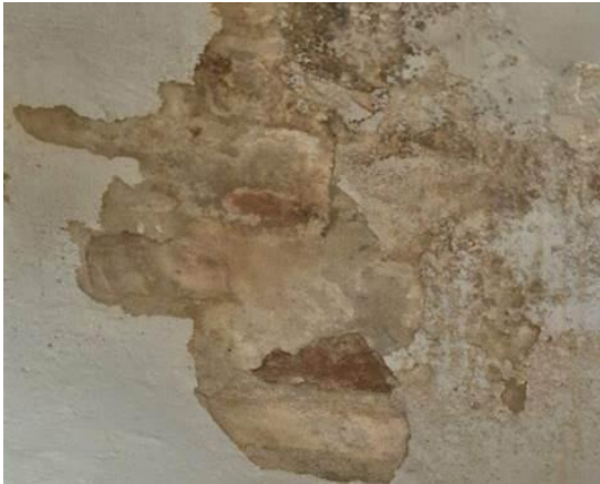
Bildexempel: Läckage i källarvägg där vatten tränger in via sprickor, otätheter eller bristfällig dränering.
