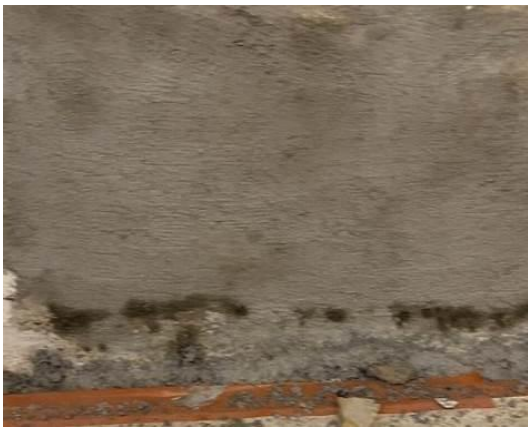
Bildexempel: Kondens på kall betongvägg i källare – uppstår när varm och fuktig inomhusluft möter kalla ytor.
